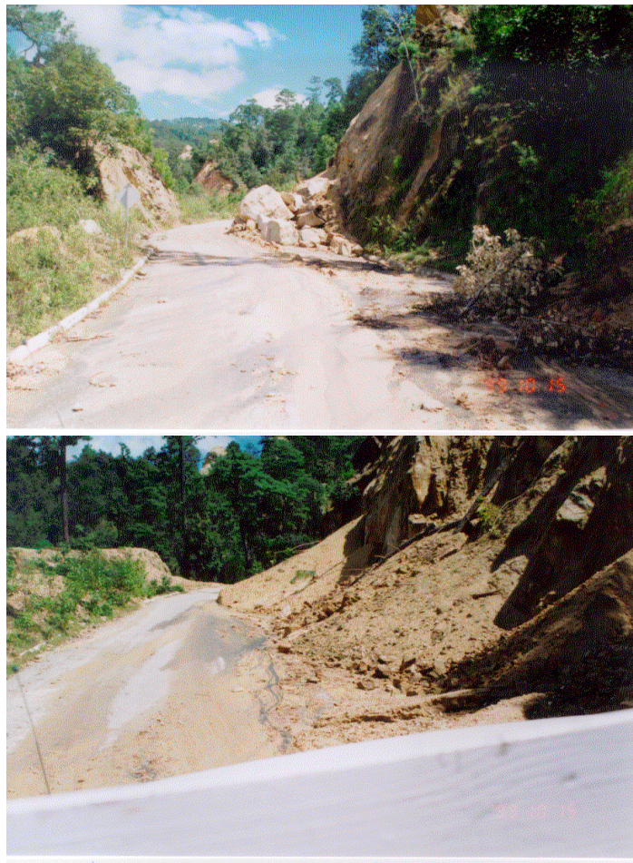
Figura 3.74 Daño en carretera, tramo El Vidrio – Juquila
