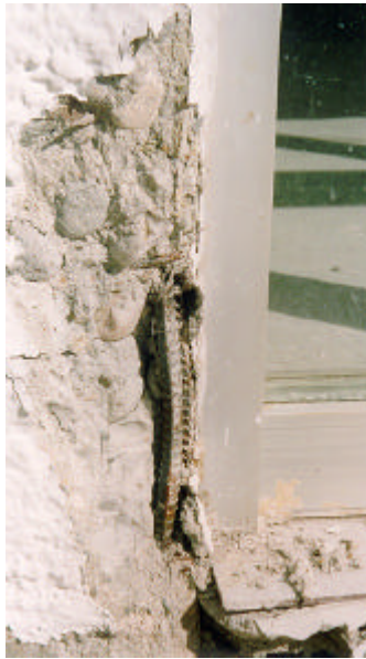
Figura 3.37 Pandeo del acero de refuerzo, agregado grueso inadecuado y separación elevada del refuerzo transversal
