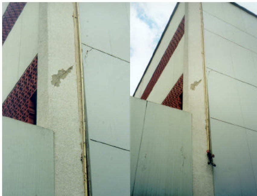
Figura 3.15 Columna con daño por tensión diagonal
