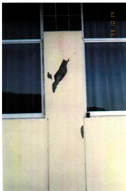
Figura 3.48 Grietas debidas a esfuerzo cortante en una de las columnas de la fachada norte
