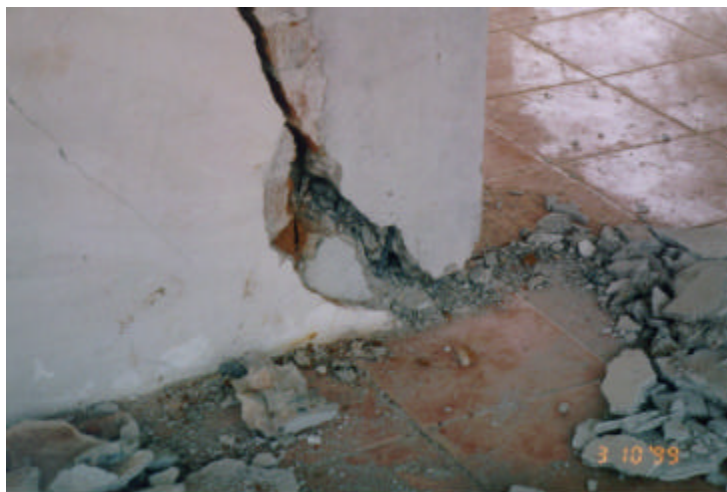
Figura 3.64 Detalle del daño en un castillo de un muro de mampostería
