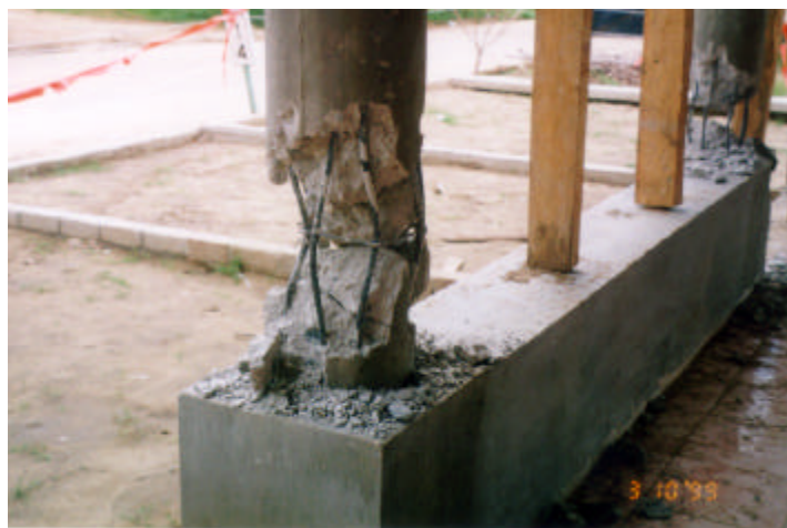
Figura 3.65 Detalle del daño en las columnas del edificio que además muestra el escaso refuerzo transversal (estribos)
