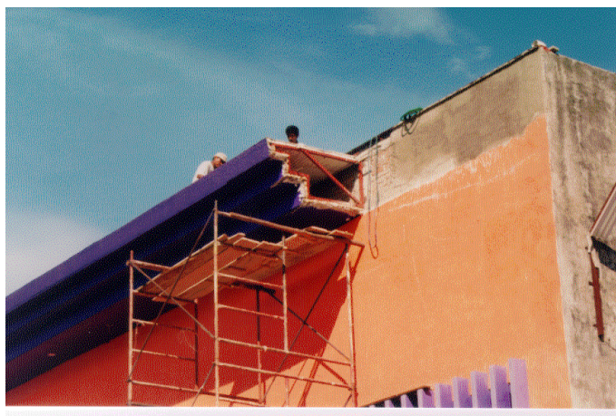
Figura 3.39 Detalle del daño en el faldón de la fachada
