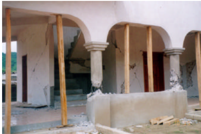
Figura 3.63 Daño en muros de mampostería y columnas de concreto
