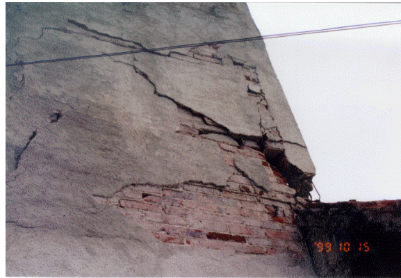
Figura 3.30 Anclaje deficiente del refuerzo longitudinal de la torre del campanario dentro del cuerpo de la iglesia
