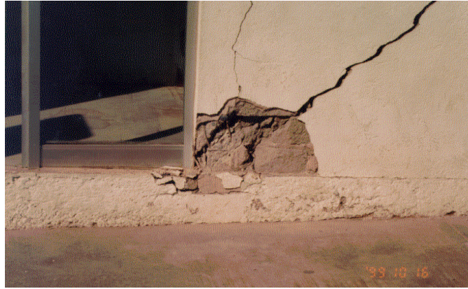
Figura 3.36 Agrietamiento en muro y columna
