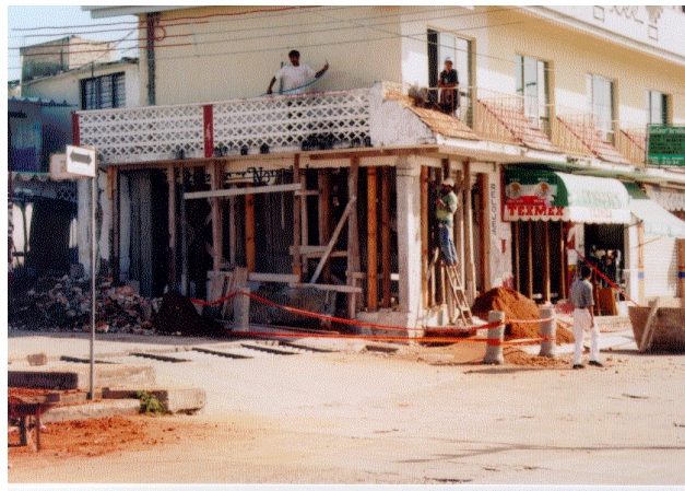
Figura 3.33 Detalle del daño y reparación del área dañada
