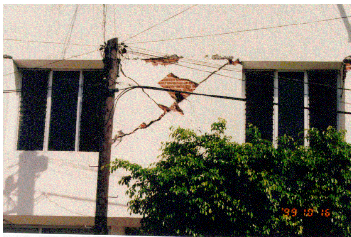
Figura 3.35 Agrietamiento en muros de fachada
