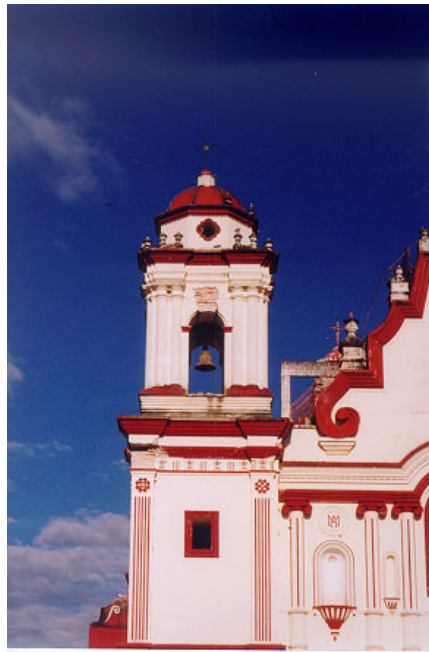
Figura 3.61 Detalle del ligero daño que presentaron las torres de la Iglesia de Santa Catarina Juquila
